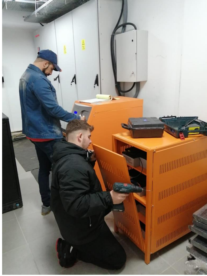
Hamidiye Külliyesi UPS Bakım ve Onarımı
